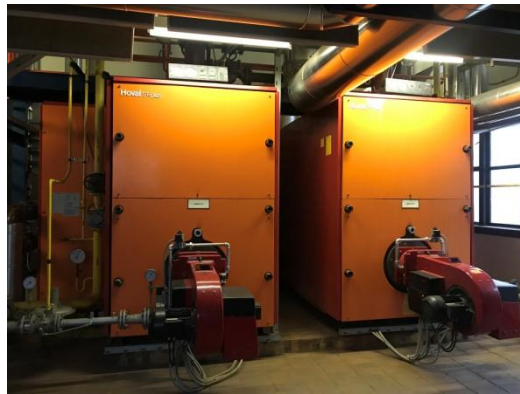
Obr. č. 10. Teplovodné kotly s horákmi
