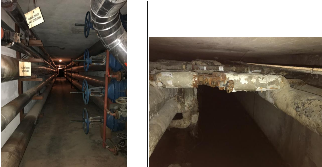
Obr. č. 15, 16. Rozvody tepla z tepelnou izoláciou.
