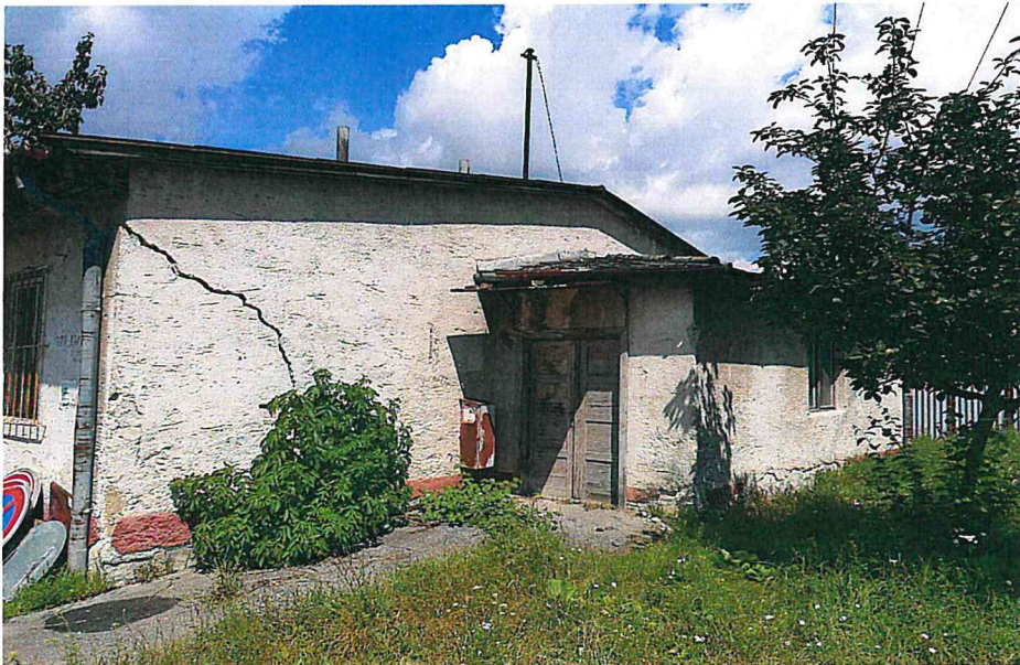
Obr. č.1 Pohľad východný /šikmá trhlina v štítovej stene/
