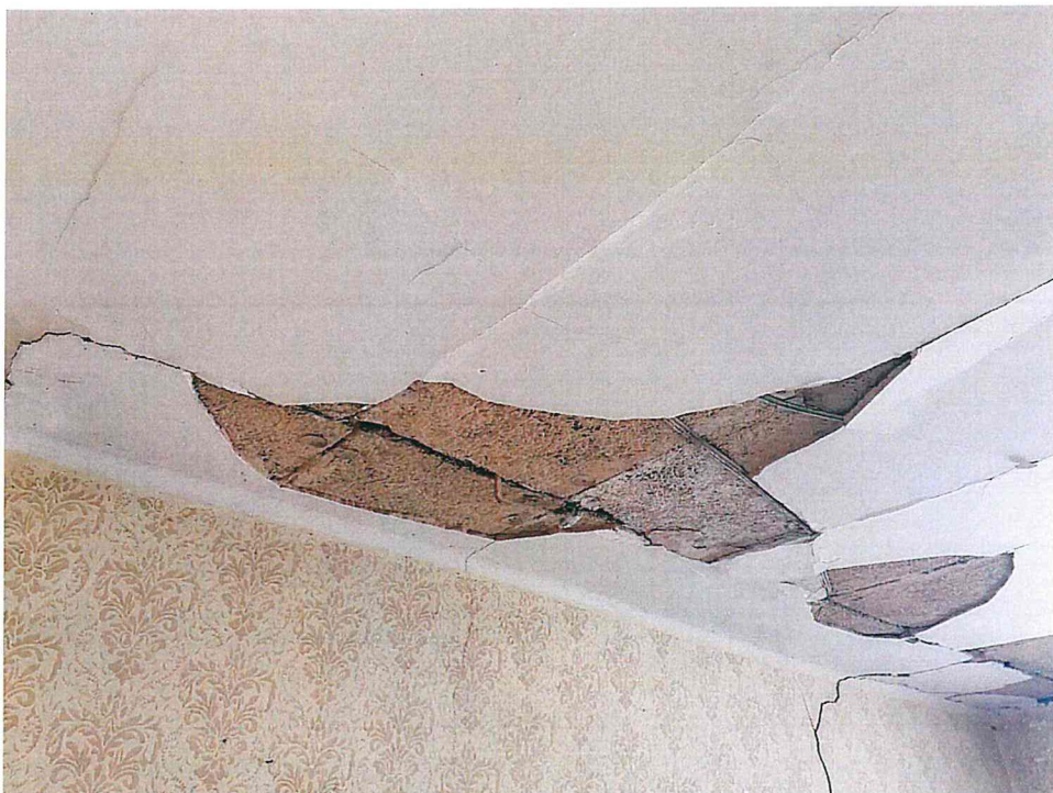
Obr.č.4 Pohľad na strop /Priehyby stropnej konštrukcie/
