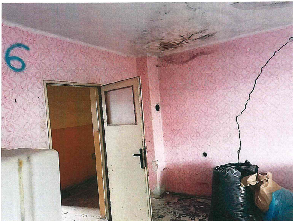
Obr.č.3 Pohľad na vnútorné steny /statická trhlina na vonkajšej stene/
